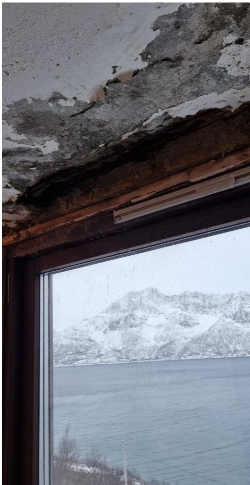
Vann trenger ned igjennom tak fra bassengrom
