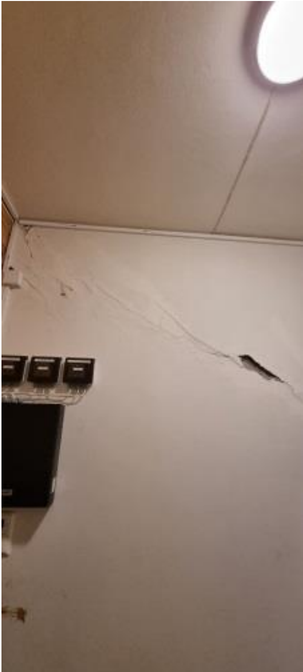
Tegn på vanninntrenging
