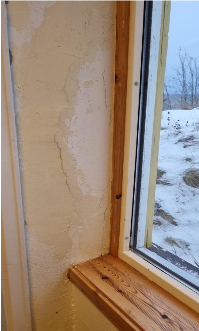
Mur sprukket som følge av fukt, gjennomgående i bygget
