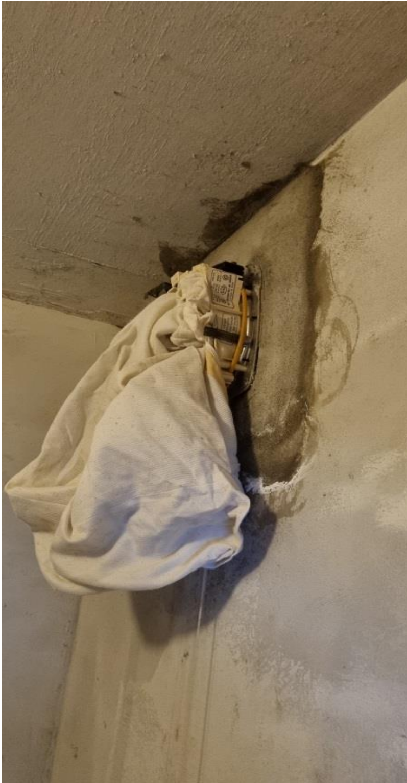
En vifte som er fjernet og tettet igjen med en provisorisk løsning
