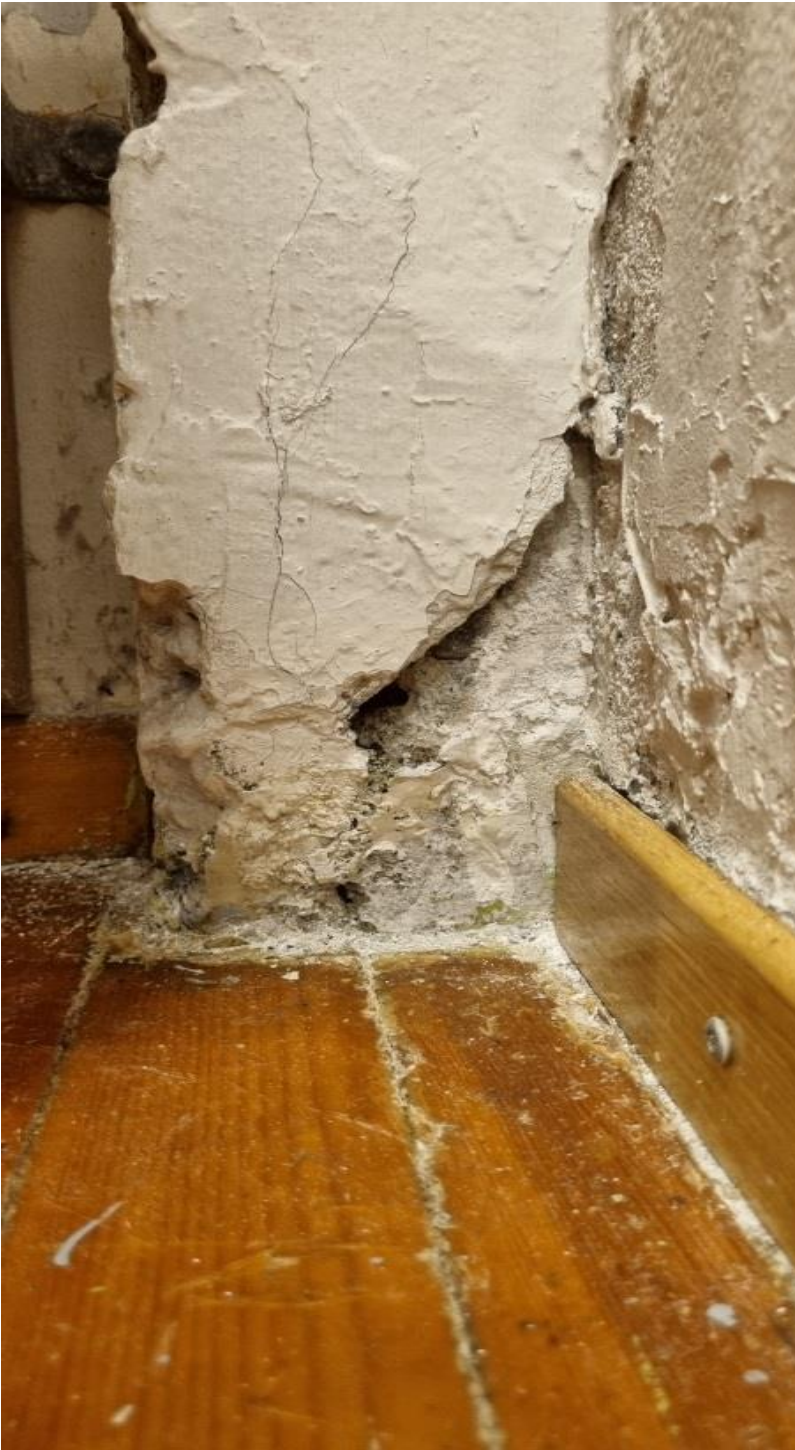
Gymsal. Konstruksjoner smuldrer opp og støvet sprer seg.
