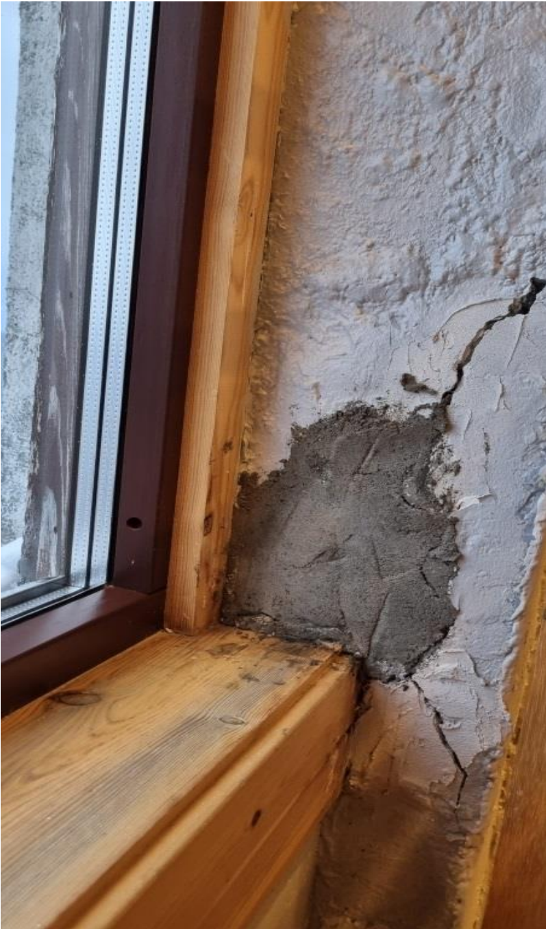
Tegn på vanninntrengning
