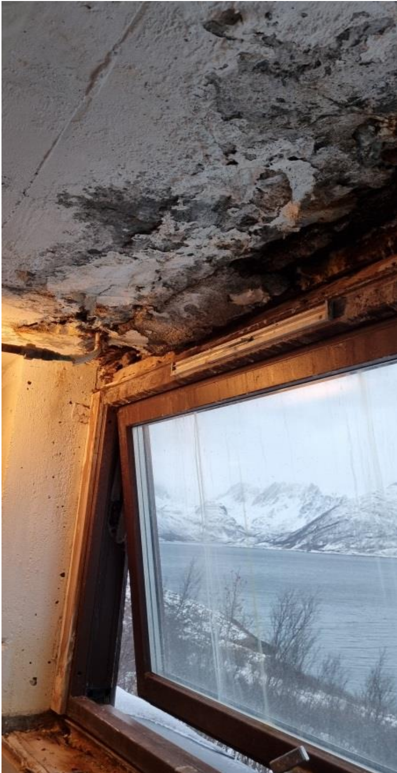
Vann som lekker ned til korridor under bassengrom
