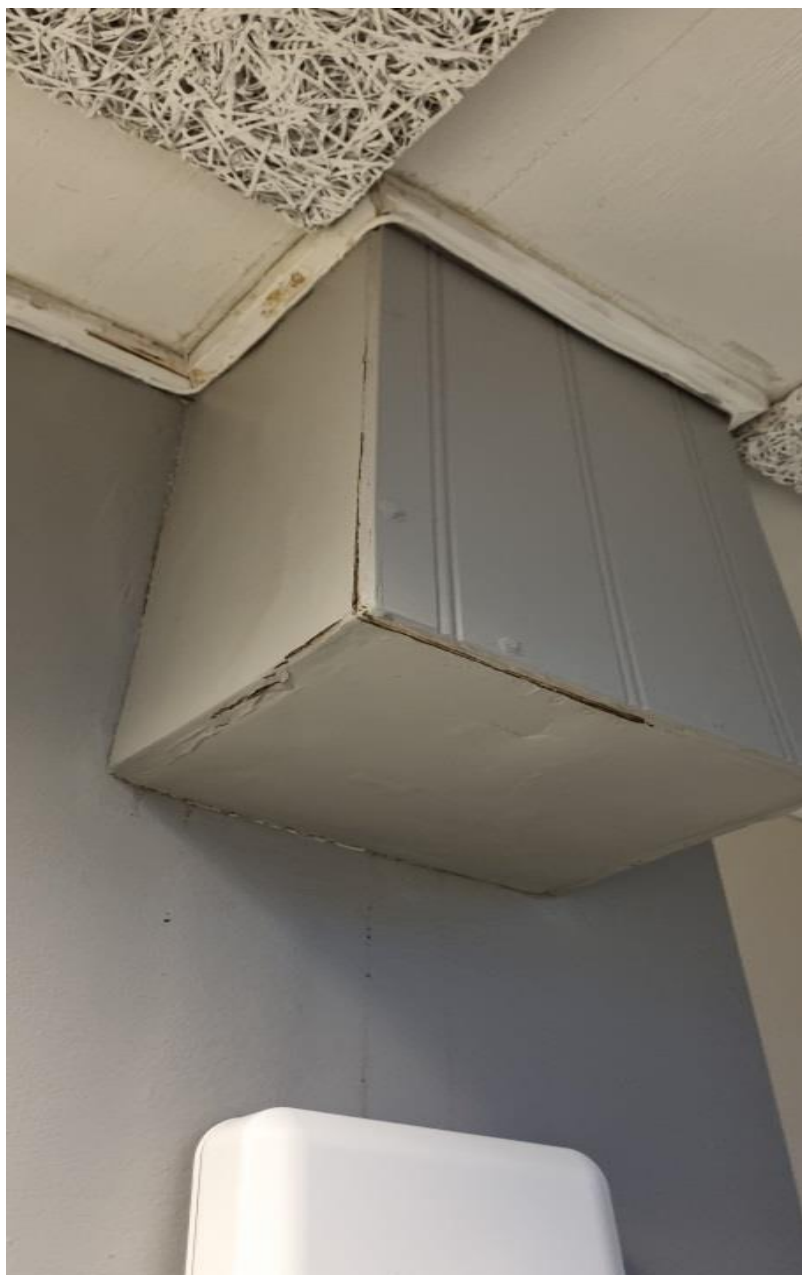
Tydelige tegn på tidligere lekkasje
