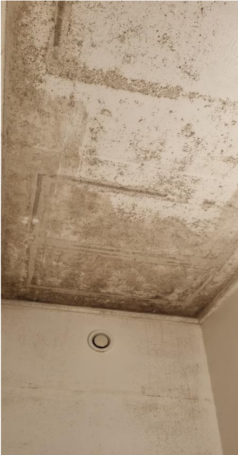
Vifte på vaskerom ute av drift, mulige soppvekster i tak.
