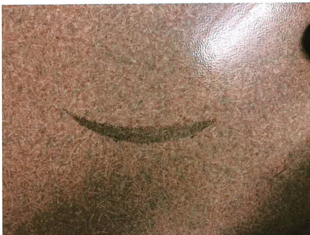
Figur 7 Slitasjer og skader på beleg
