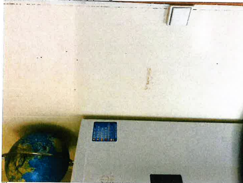
Figur 10 Merker i vegg skaper også et dårlig visuelt inntrykk
