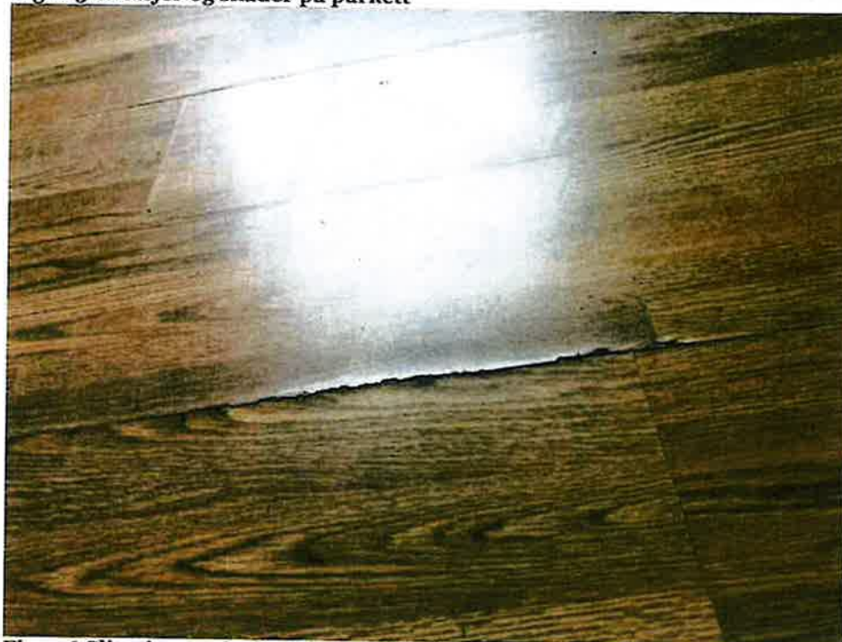
Figur 6 Slitasjer og skader på parkett
