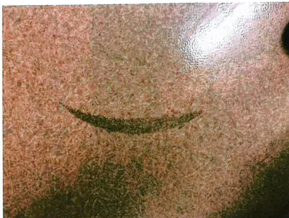
Figur 7 Slitasjer og skader på belegg
