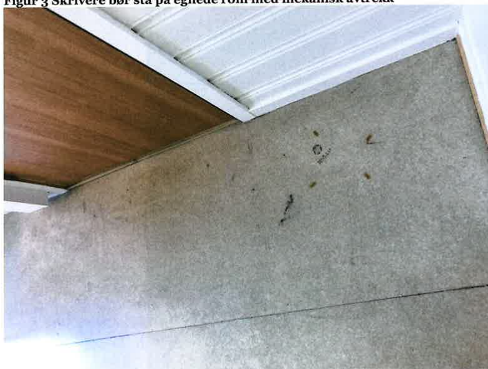
Figur 4 Slitasjer og skader på belegg
