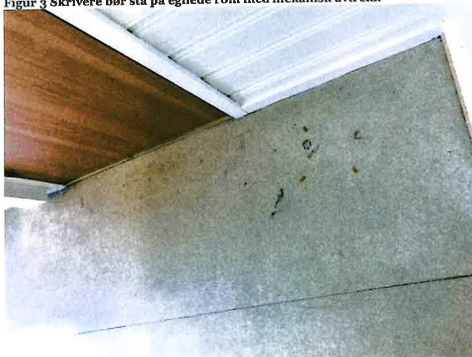
Figur 4 Slitasjer og skader på belegg
