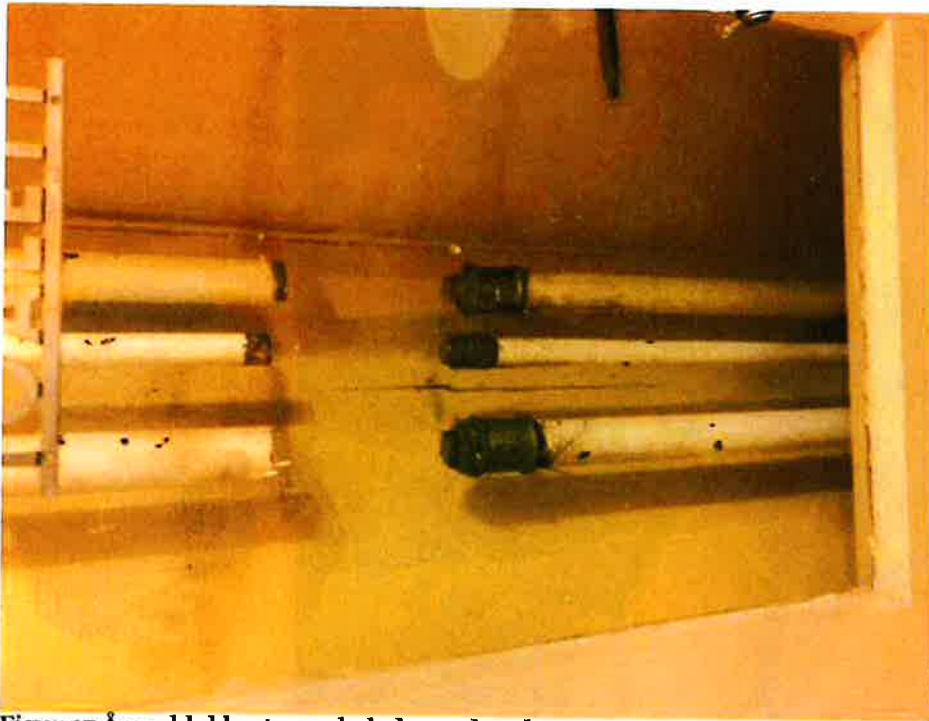
Figur 17 Åpne blokkerte rør bak dør ved toaletter
