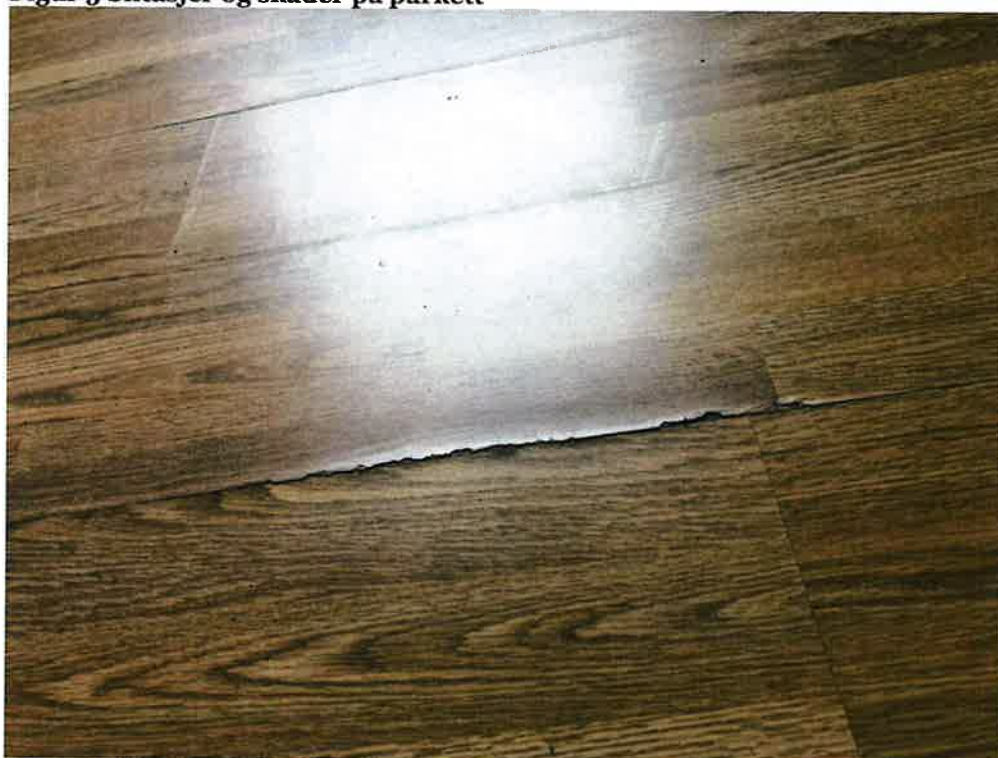
Figur 6 Slitasjer og skader på parkett
