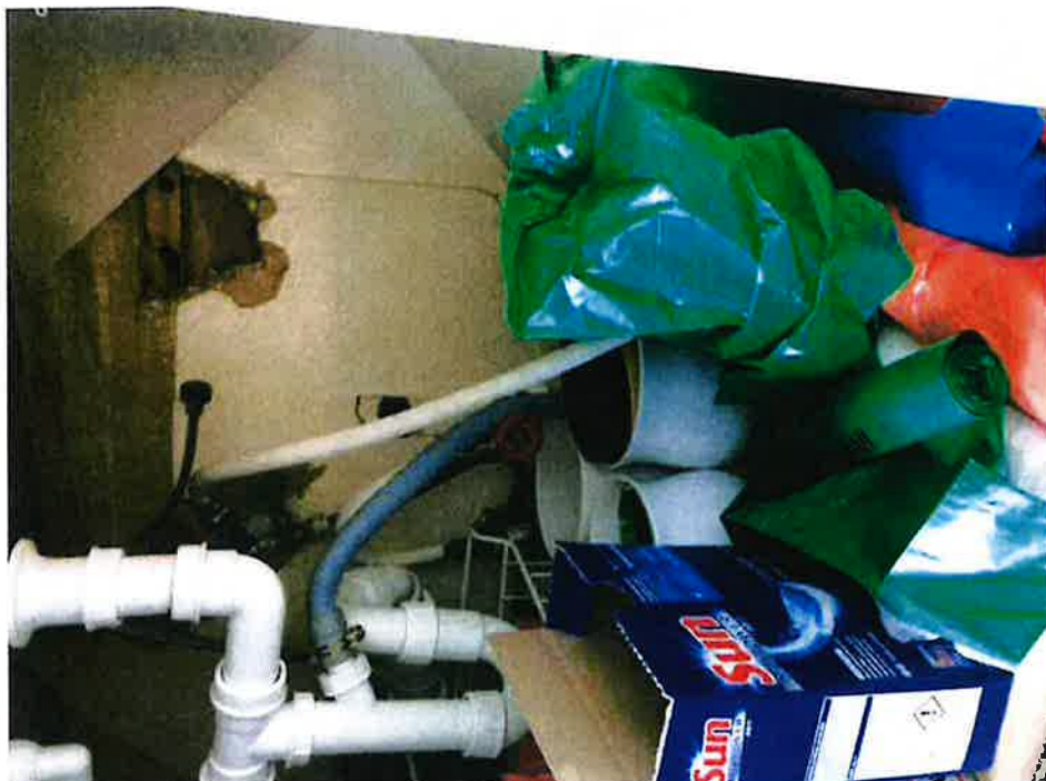
Figur 11 Skader under vask på pauserom
