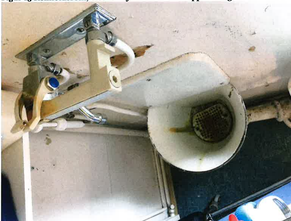
Figur 16 Slitasje bygningsverk, trangt og utilpasset renholdsrom
