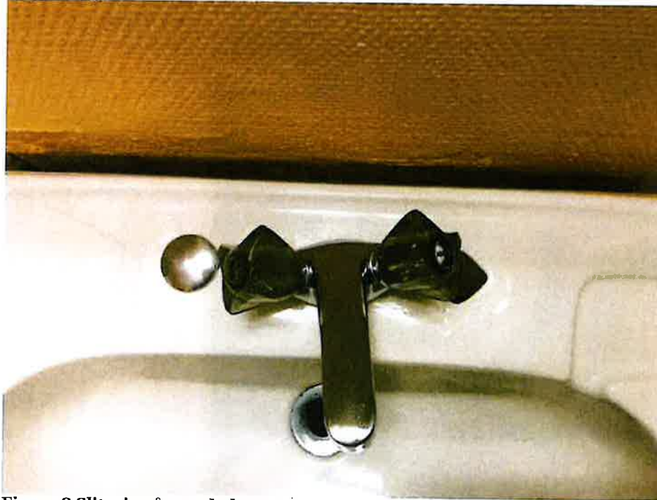
Figur 18 Slitasje på vegg bak servant
