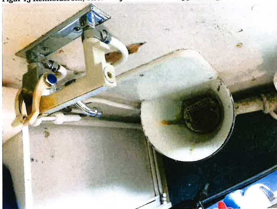
Figur 16 Slitasje bygningsverk, trangt og utilpasset renholdsrom
