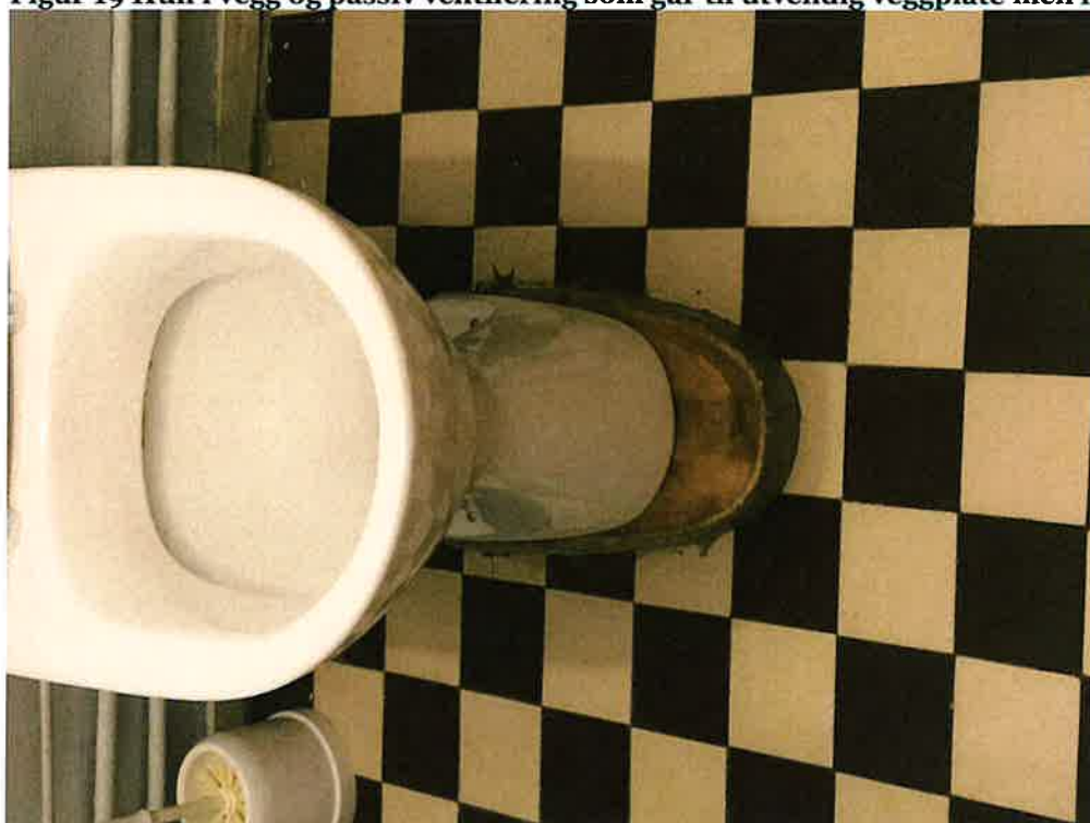
Figur 20 Sprukne fliser og avkapp av ved stubb under toalett
