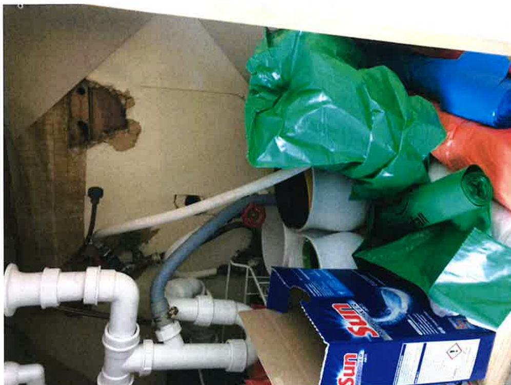
Figur 11 Skader under vask på pauserom
