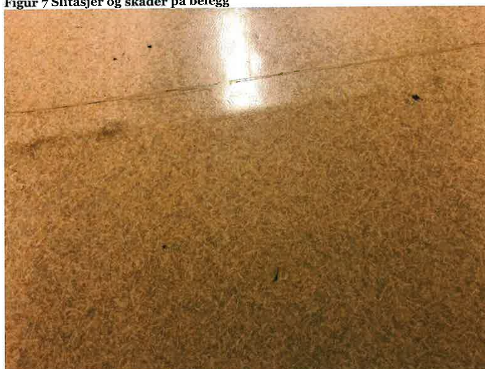
Figur 8 Slitasjer og skader på beleg
