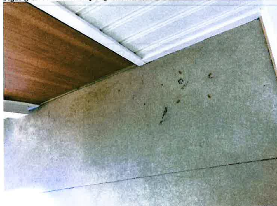
Figur 4 Slitasjer og skader på belegg
