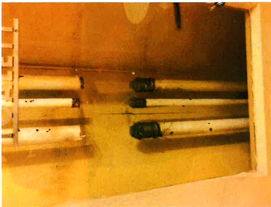
Figur 17 Åpne blokkerte rør bak dør ved toaletter
