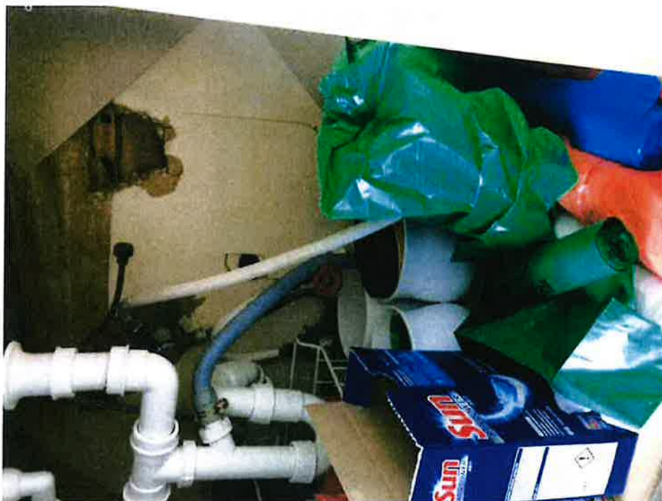
Figur 11 Skader under vask på pauserom
