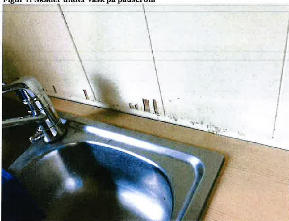
Figur 12 Slitasje/skade bak vask på pauserom
