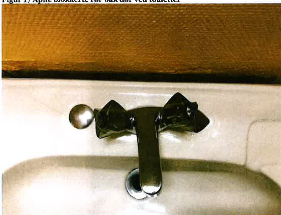
Figur 18 Slitasje på vegg bak servant
