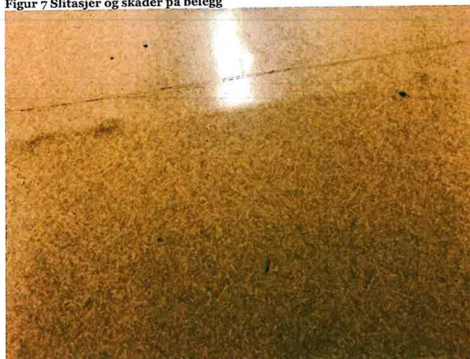
Figur 8 Slitasjer og skader på belegg
