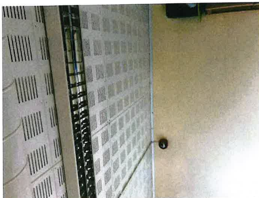
Figur 3 Harde himlingsplater som bør monteres senket, flyttes fra 2. etg. og ned.
