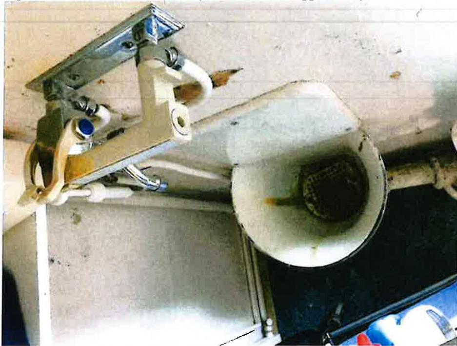
Figur 16 Slitasje bygningsverk, trangt og utilpasset renholdsrom
