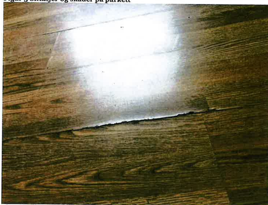
Figur 6 Slitasjer og skader på parkett
