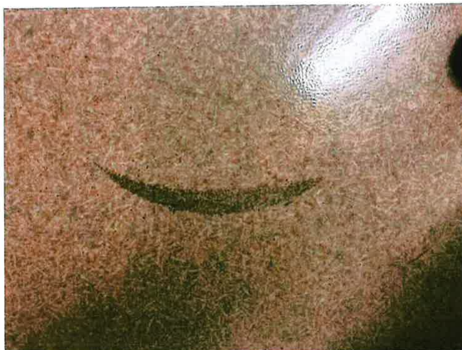
Figur 7 Slitasjer og skader på belegg
