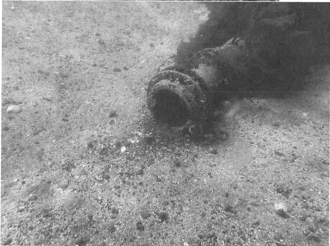
Rørledning fortsetter, en del dårlige lodd. Mye tæring på betong i lodd. Røret har en skade etter å ha vært fast i anker fra båt.
