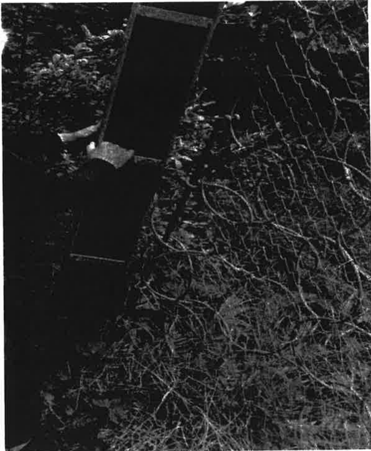
Figur 5. Korrosjon på vertikal bærewire
