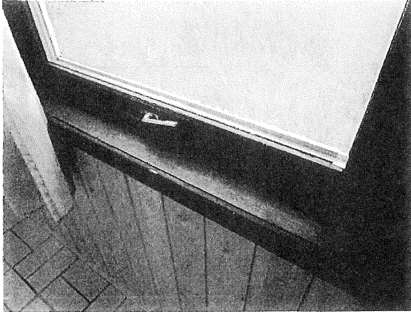
A3. Vinduer punktert
