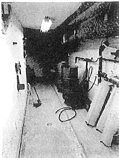
Bilde 7 Teknisk rom
