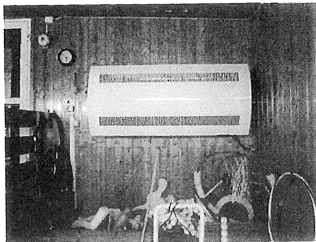
Bilde 6 Luftavfukter i bassengrommet
