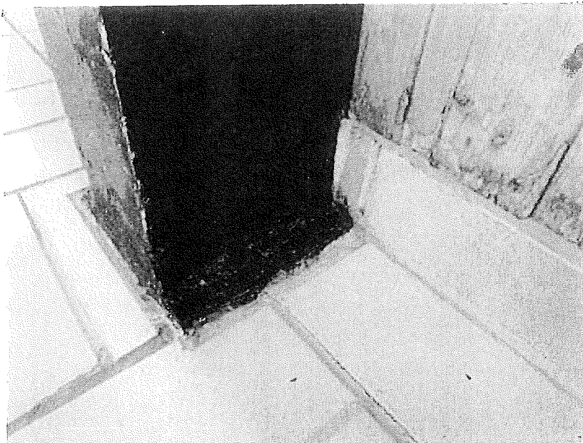
A5. Lakkavflassing trepanel og rust fotplate søyle. Det vises også sprekk i flisefug.
