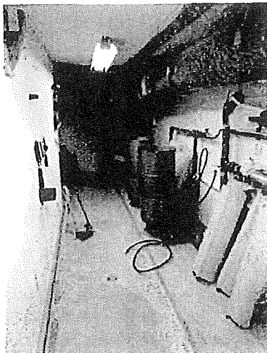
Bilde 7 Teknisk rom
