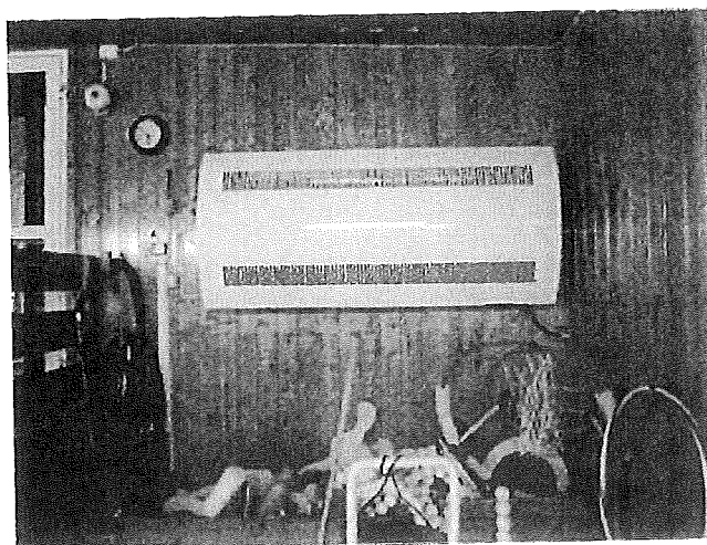
Bilde 6 Luftavfukter i bassengrommet
